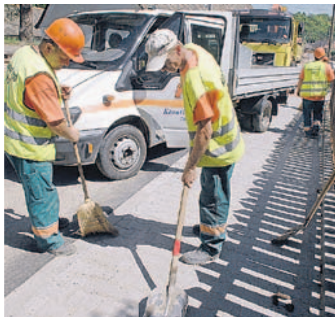
A Völgyesség egyik legszebb településén, Báticaapátiban több beruházást is megvalósított az elmúlt időszakban a KÉSZ Kft. A képen látható Petőfi utcában térköveztek, kibővítették az utat és a csapadékvíz-elvezetést is megoldották ezen a területen a cég munkatársai
